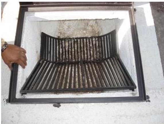
Canal con rejilla para sólidos
